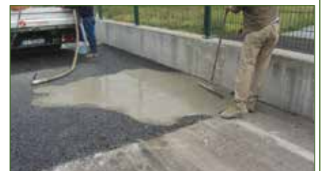
La saturazione delle porosità del conglomerato con una speciale malta cementizia BETON FLUID PRONTO ha lo scopo di aumentarne la portanza per sopportare il traffico pesante
