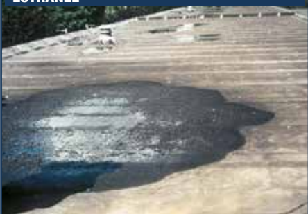
POZZANGHERA CON DEPOSITO DI SOSTANZE ESTRANEE
