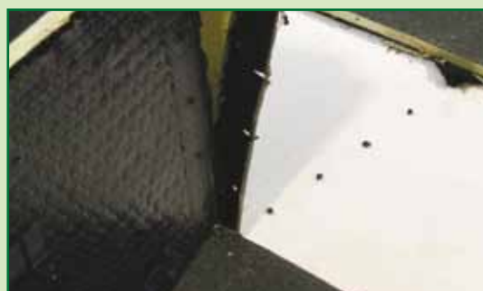
6 Non vengono evidenziate alterazioni del polistirolo. Segnale che la fiamma non ha superato il sormonto chiodato di PROMINENT
