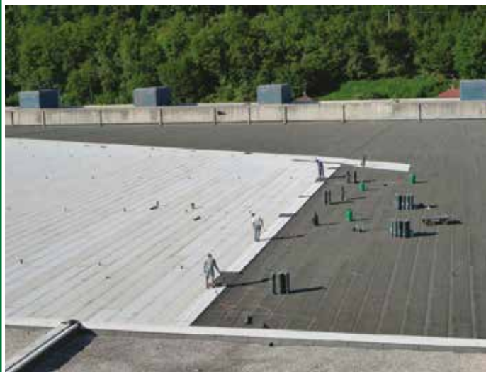
Si notino le differenze di colore fra rotoli anche della stessa partita che sul pallet hanno subito un diverso riscaldamento
