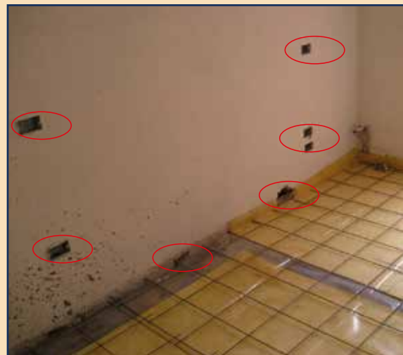
Scatole elettriche contrapposte
